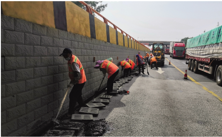
为抓实雨季前给排水管道疏通工作,连日来,华茂公司组织人员对辖区所有下水道、排水沟等给排水设施进行巡查治理,确保雨季排水设施畅通,路面、涵洞不留积水,保障道路交通安全。(张青松 于广华)
